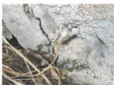
Fissure + armature nue à reprendre
