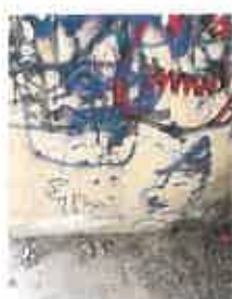
Revettements ( Enduit ) dégradés
