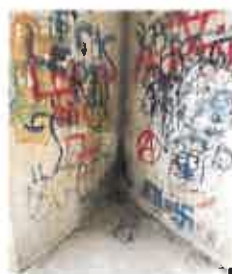
Revettements ( Enduit ) dégradés
