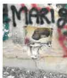
Revettements ( Enduit ) dégradés
