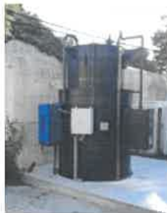
Exemple de poste hors sol
